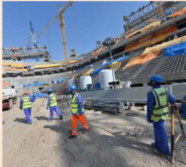
← Bygningsarbeidene er i gang i en tidlig fase ved Qatars Lusail stadion, to mil nord for hovedstaden Doha. Arkivfoto: Giuseppe Caccace/AFP/NTB
